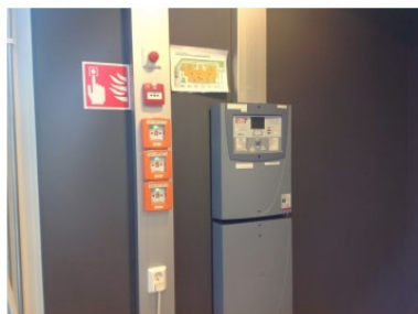
IV-hätäseis paloilmoittimen vieressä
